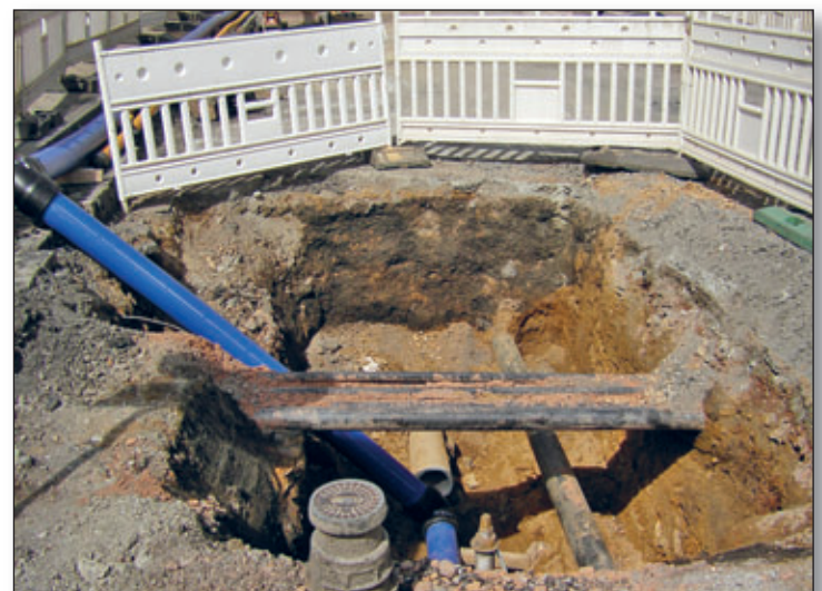
Die Arbeiten an den Versorgungsleitungen in der Stollberger Straße gehen planmäßig voran.
